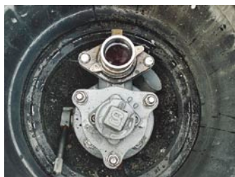
地下に埋設された消火栓の内部
