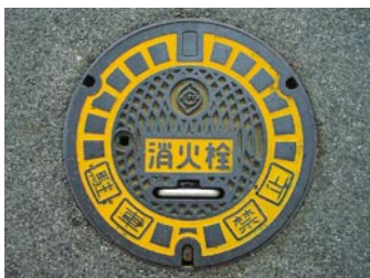
地下に埋設された消火栓の例
